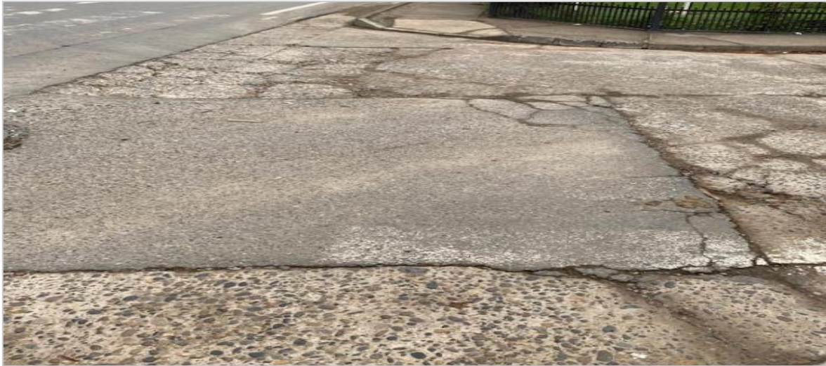
Fotografía N°1: Calle en mal estado en la localidad de Hualañé
