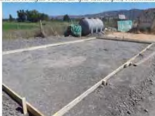
Fig. 4 Construcción nuevo Punto Limpio en enero 2022, ubicado en zona de estacionamiento municipal
